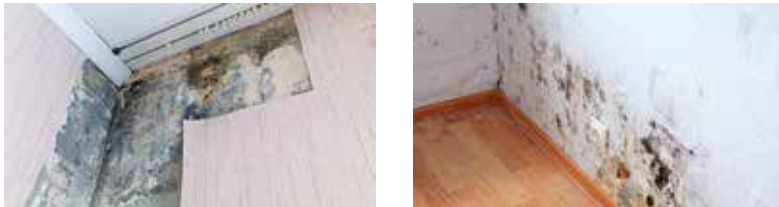
Рис. 7.3. Пліснява на стінах квартири
